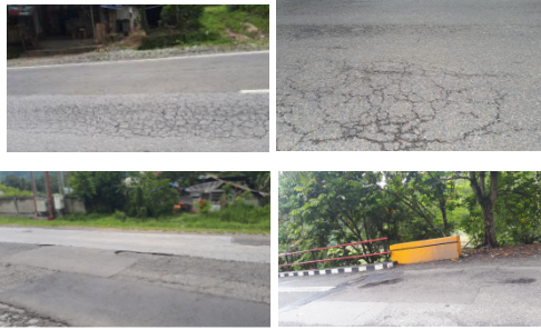
Gambar 1: kerusakan yang terjadi pada ruas jalan Solok-Sawah Lunto; retak buaya (kiri atas), retak memanjang dan melintang (kanan atas), tambalan (kiri bawah) dan lobang
